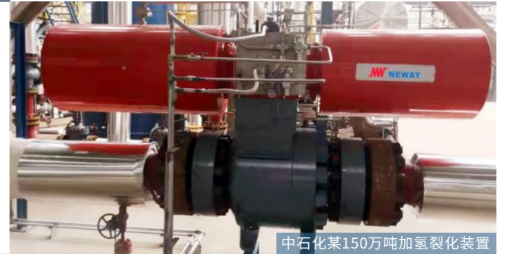
中石化某150万吨加氢裂化装置
